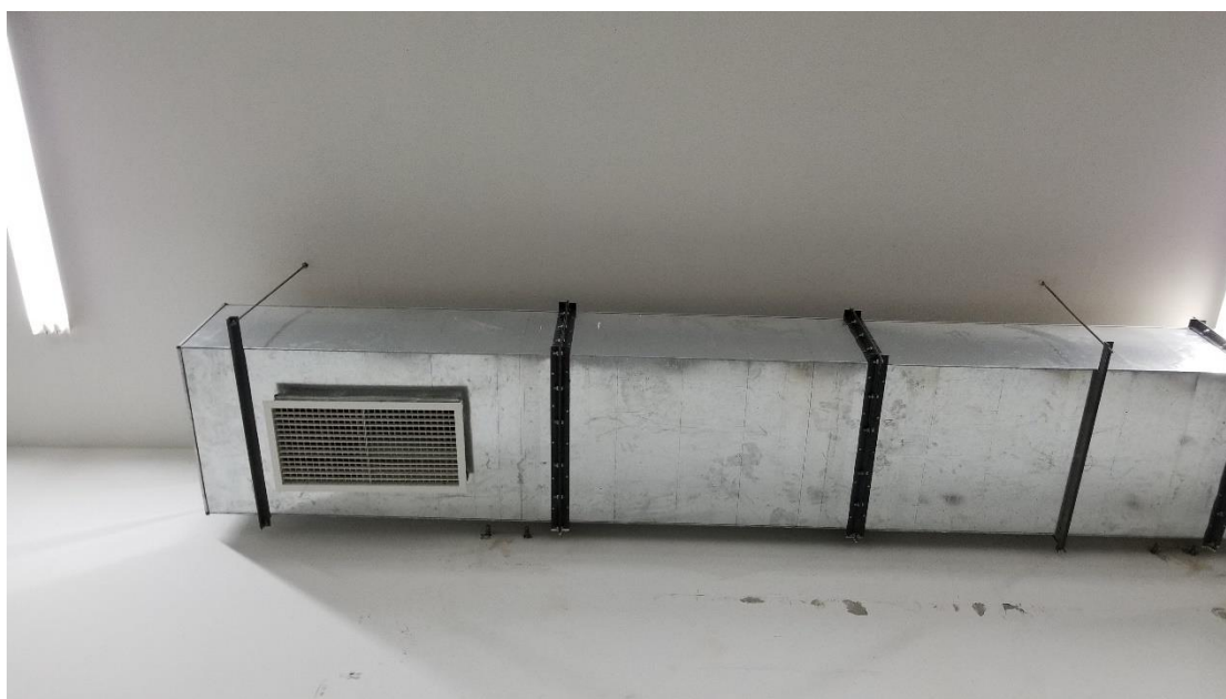
附图 7 CT 检测间通风装置
