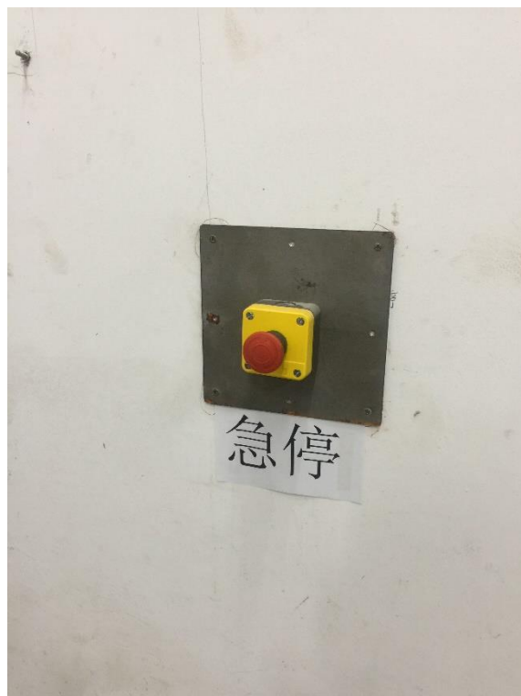
附图 9 检测间内急停按钮和急停拉线
